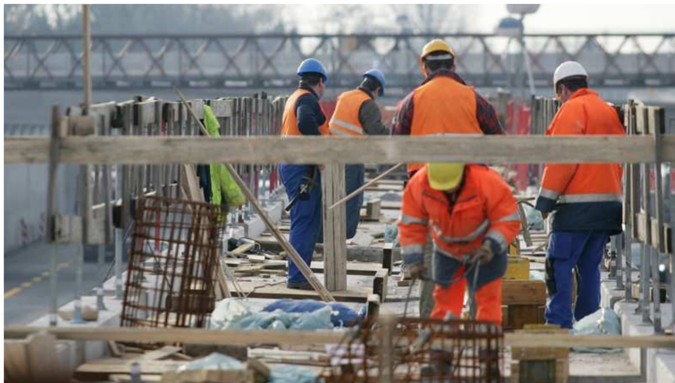
Die Arbeiten für den Wesertunnel sollen im Januar 2019 beginnen. Für die Anschlussstelle zwischen Neuenlander Ring und dem Zubringer Arsten soll es im Frühjahr 2019 losgehen. Bild: DPA | Ralph Goldmann
